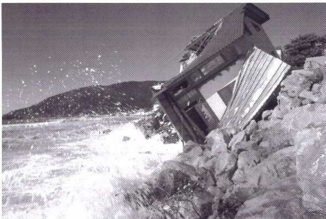
Às 11h26min a casa ainda não havia sido derrubada pela ressaca (Edu Cavalcanti)
